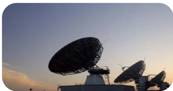
● 神戸航空衛星センター 地上局施設
