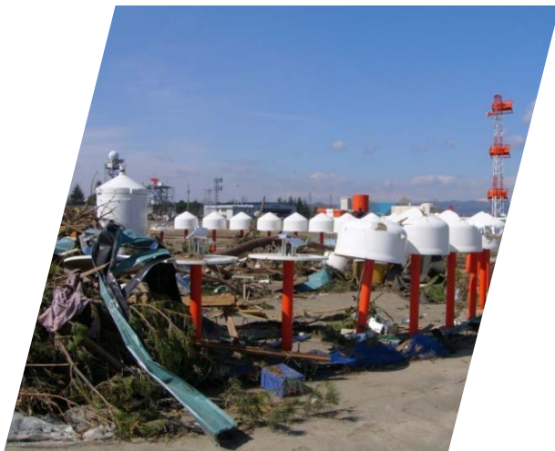
●津波により破壊されたVOR空中線
