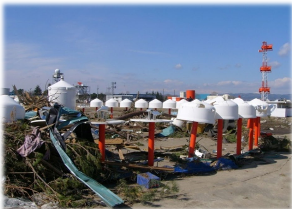
●津波により破壊されたVOR空中線
