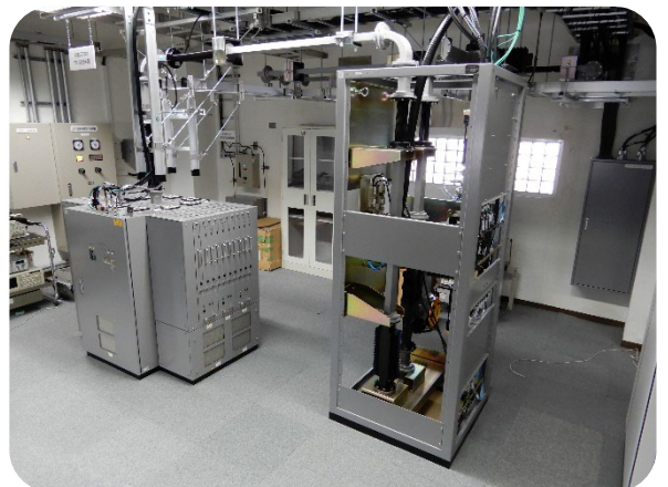
●PSR送信装置(出力10kW)
