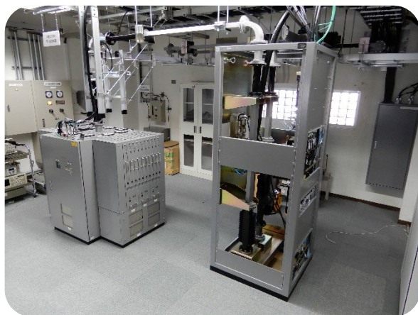
●PSR送信装置(出力10kW)
