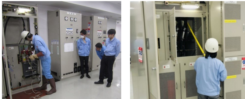
【電力機器取扱 実技（停電作業）】
