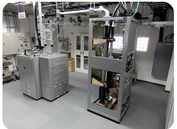
●PSR送信装置(出力10kW)
