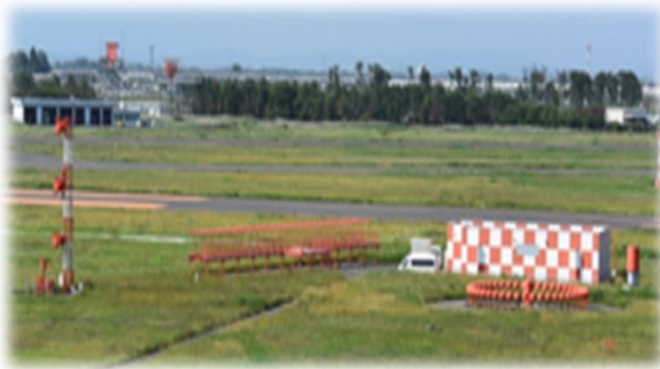
【NAV 局舎及び訓練施設】
