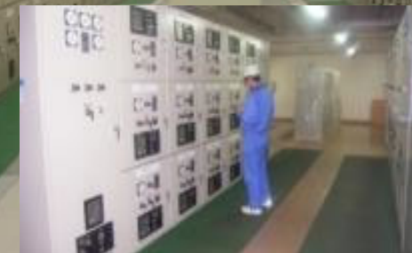
電気施設の日常点検
