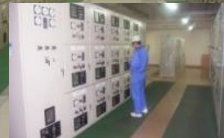
電気施設の日常点検
