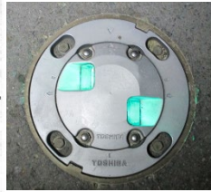
誘導路中心線灯 (TCLL)
