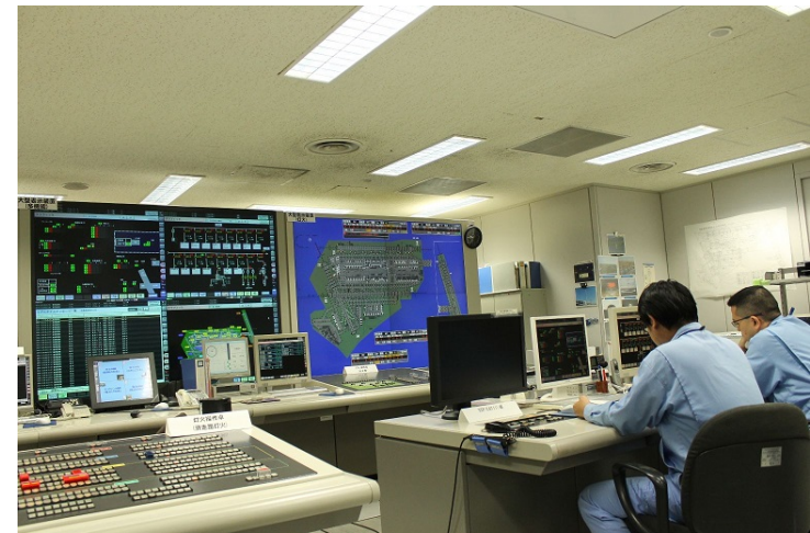
灯火電力監視制御装置
