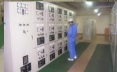
電気施設の日常点検
