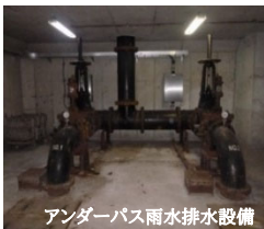
アンダーパス雨水排水設備
