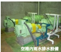
空港内雨水排水設備
