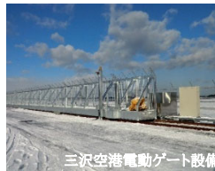
三沢空港電動ゲート設備
