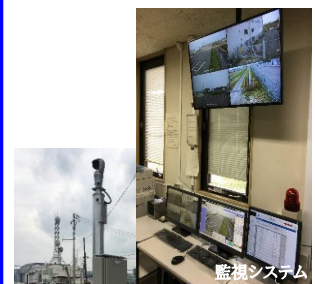
監視システム
