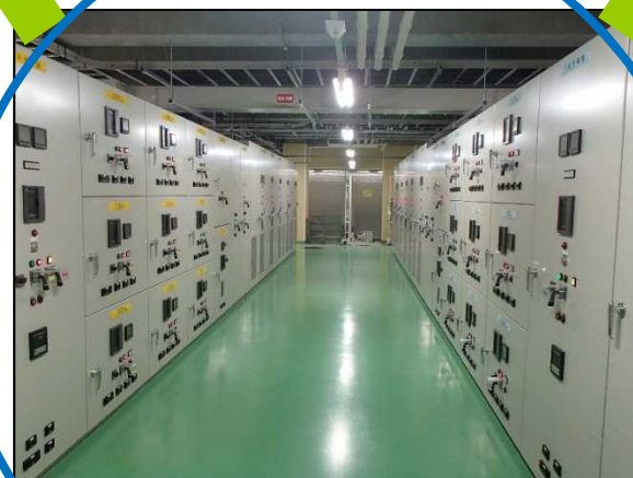
電力供給設備
