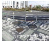
汚水排水中継ポンプ設備 (羽田空港)
