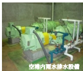
空港内雨水排水設備
