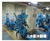
上水配水設備
