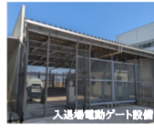
入退場電動ゲート設備
