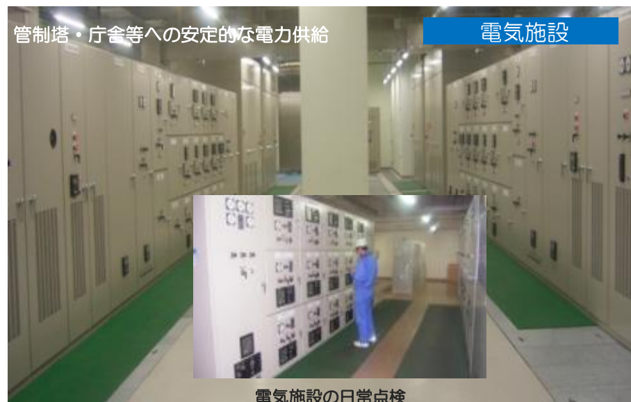
電気施設の日常点検
