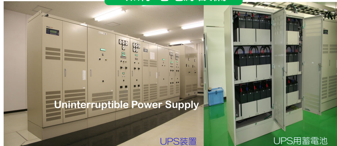
無停電電源設備
