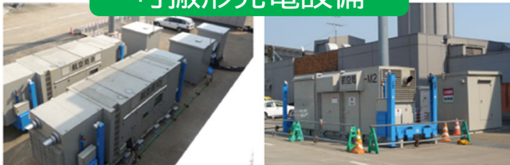
可搬形発電設備
