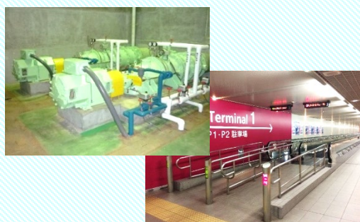
空港機能を担う機械設備
