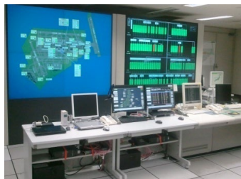
機械施設監視装置
