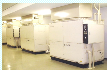
庁舎・管制塔などの建築設備
