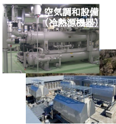
空気調和設備(航空保安施設用)
