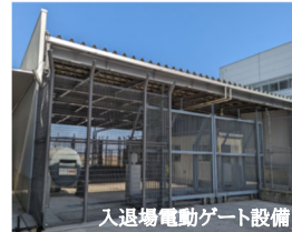
三沢空港電動ゲート設備
