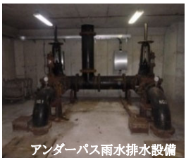
空港内雨水排水設備
