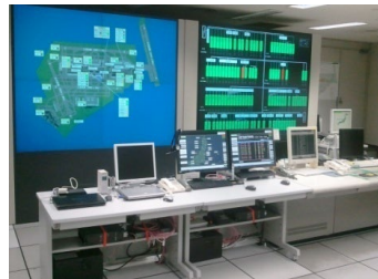
機械施設監視装置
