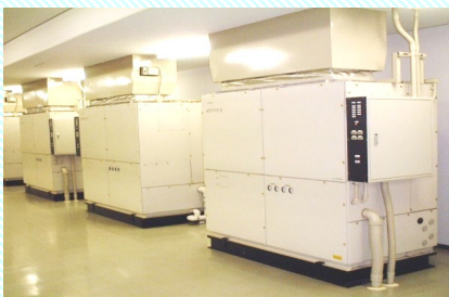
庁舎・管制塔などの建築設備
