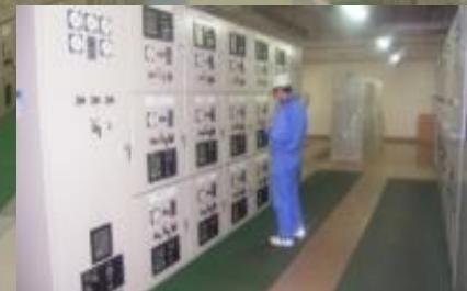
電気施設の日常点検
