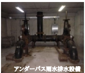
アンダーパス雨水排水設備
