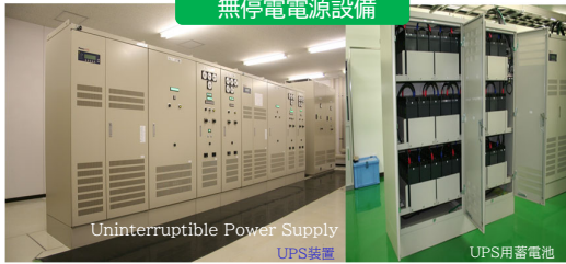
無停電電源設備
