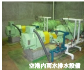
空港内雨水排水設備
