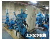
上水配水設備
