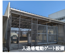
三沢空港電動ゲート設備
