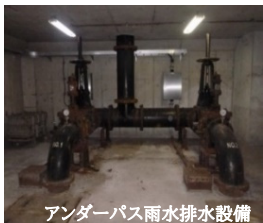
アンダーパス雨水排水設備
