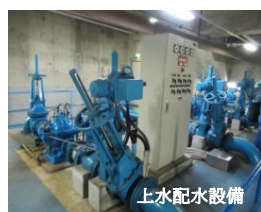
上下水道関連設備
