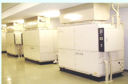
庁舎・管制塔などの建築設備
