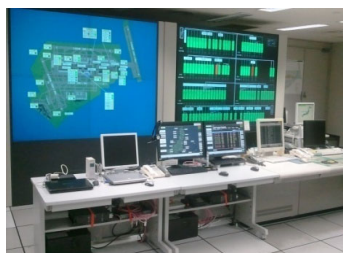
機械施設監視装置
