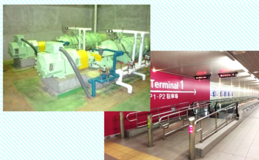
空港機能を担う機械設備
