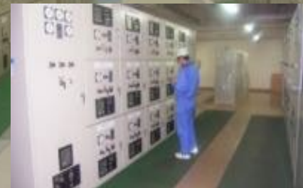
電気施設の日常点検
