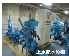
上下水道関連設備
