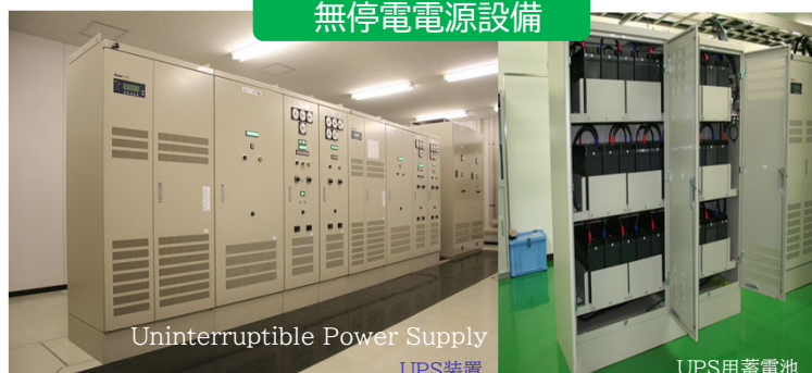
無停電電源設備
