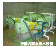
空管内雨水排水設備
