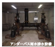
アンダーパス雨水排水設備
