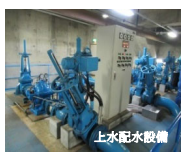
上下水道関連設備
