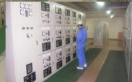
電気施設の日常点検
