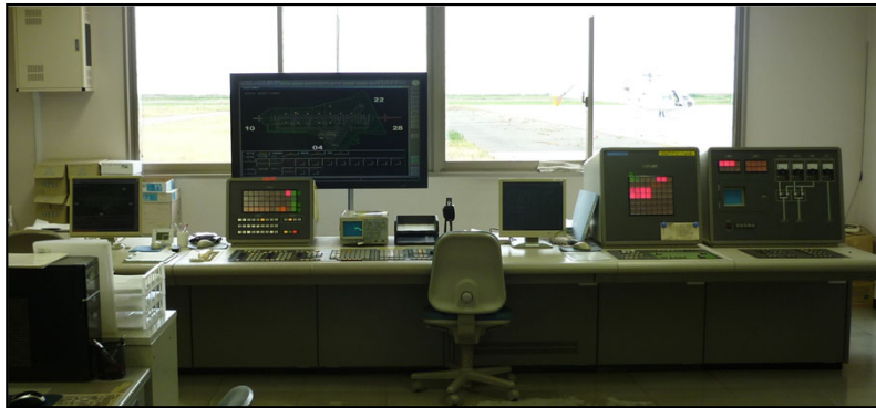
灯火電力監視制御装置
