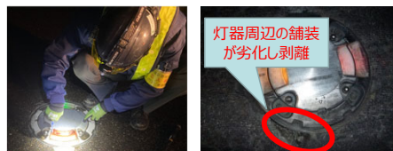
埋込型灯器 通常点検
