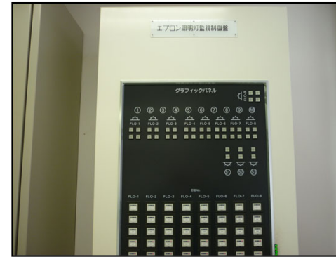
エプロン照明灯監視制御システム
