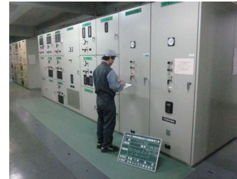
電気施設巡回点検の様子
