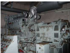
庁舎に設置されている発電設備は 津波による被災で使用できず…
