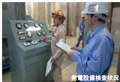
発電設備検査状況
