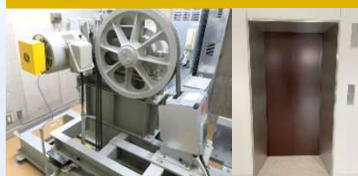
管制塔・庁舎内の人や荷物を移動させるための設備
