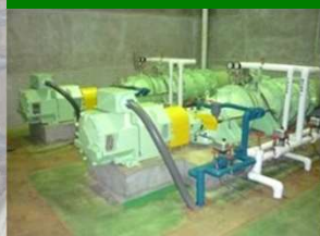
空港内の道路やアンダーパスなどの雨水排水ポンプ設備
