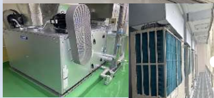
VFR室、無線機器室、一般室などの室内環境の調整を行う設備
