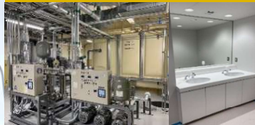
管制塔・庁舎へ業務に欠かせない水を届ける設備
