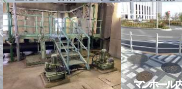
マンホール内 空港内で発生する下水を公共下水道へ排水する設備
