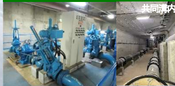
共同溝内 空港内の各所へ上水を配水する設備
