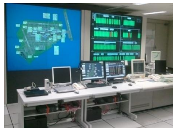
機械施設監視装置
