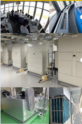
VFR室、無線機器室、一般室などの室内環境の調整を行う設備
