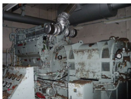
庁舎に設置されている発電設備は 津波による被災で使用できず…
