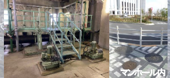
マホール内 空港内で発生する下水を公共下水道へ排水する設備
