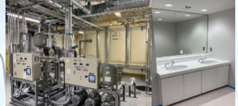
管制塔・庁舎へ業務に欠かせない水を届ける設備
