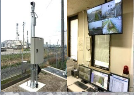
制限区域への不法侵入者を監視する警備システム
