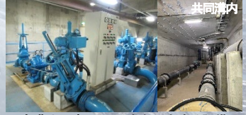
共同室内 空港内の各所へ上水を配水する設備
