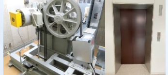
管制塔・庁舎内の人や荷物を移動させるための設備
