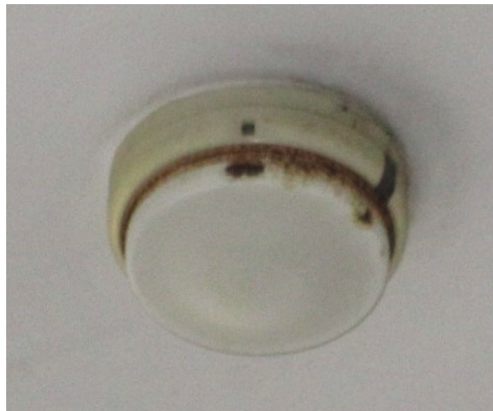
既設差動式スポット型感知器
