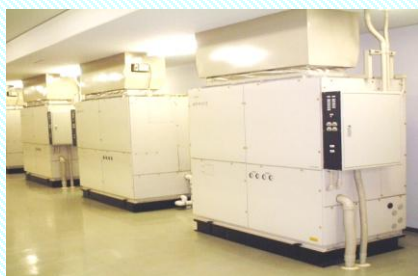
庁舎・管制塔などの建築設備
