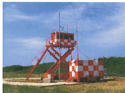
非常用管制塔設備（展開後）
