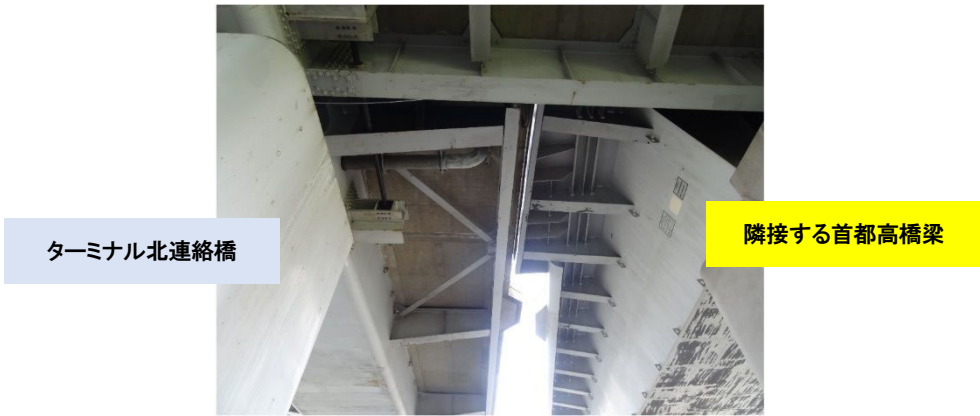
写真-5.1 形状の差異による塗装の劣化の相違の例
