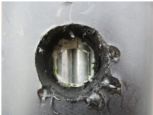
図-5.4 No. 614 ケーブル内部状況
