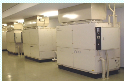
庁舎・管制塔などの建築設備
