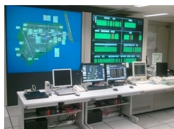
機械施設監視装置
