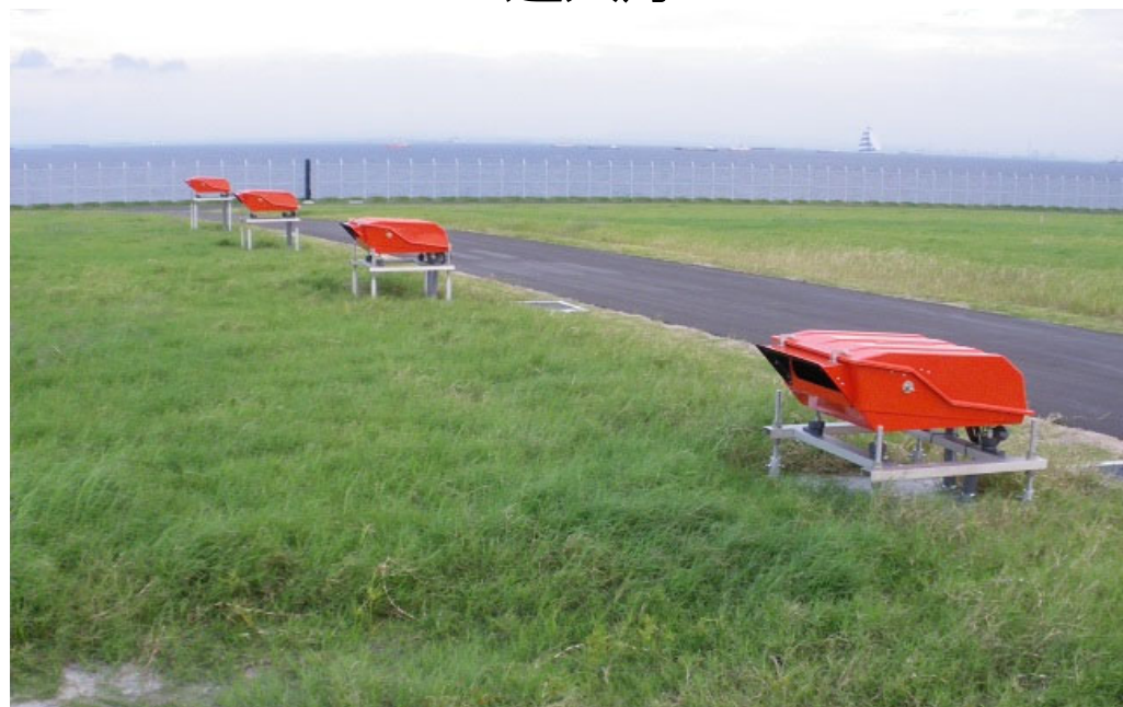
進入角指示灯
