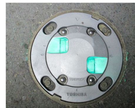
誘導路中心線灯(埋込型)
