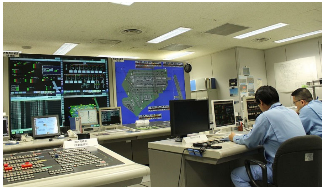
灯火電力監視制御装置
