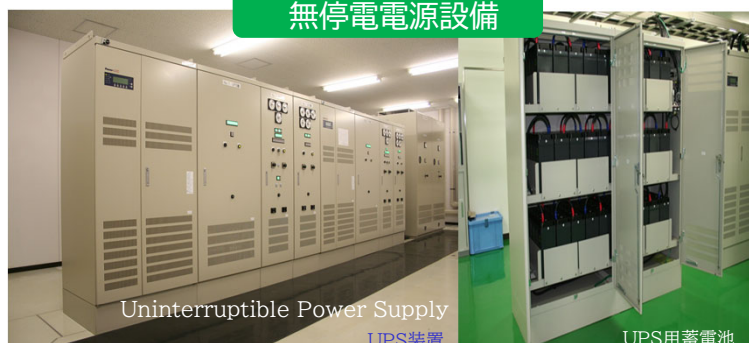
無停電電源設備
