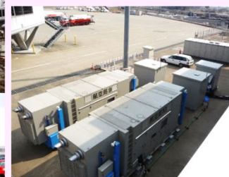
空港の運用に必要な電源を確保
