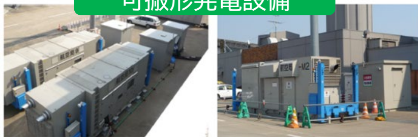
可搬形発電設備
