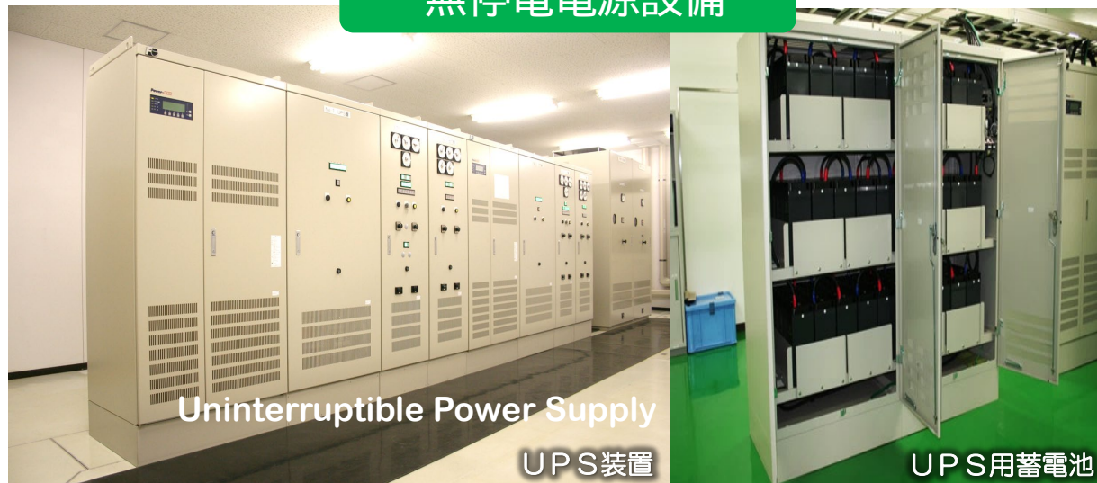
無停電電源設備
