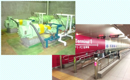
空港機能を担う機械設備
