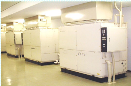
庁舎・管制塔などの建築設備
