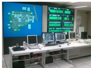
機械施設監視装置
