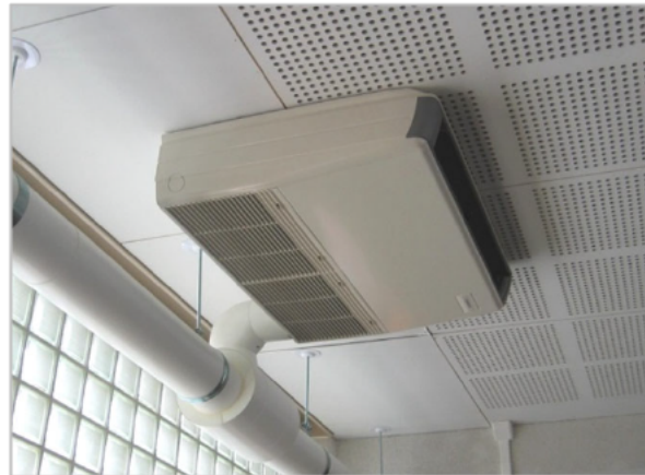
空調機(室内機)
