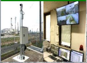
制限区域への不法侵入者を監視する警備システム
