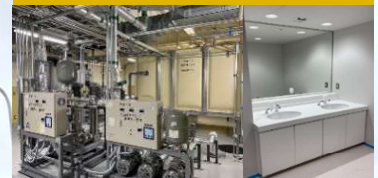
管制塔・庁舎へ業務に欠かせない水を届ける設備
