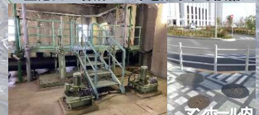
マンホール内 空港内で発生する下水を公共下水道へ排水する設備
