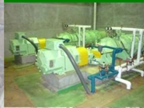
空港内の道路やアンダーパスなどの雨水排水ポンプ設備
