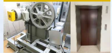
管制塔・庁舎内の人や荷物を移動させるための設備
