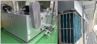
VFR室、無線機器室、一般室などの室内環境の調整を行う設備
