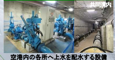
共同溝内 空港内の各所へ上水を配水する設備
