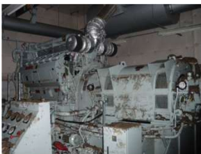
庁舎に設置されている発電設備は津波による被災で使用できず…
