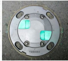
誘導路中心線灯 (TCLL)
