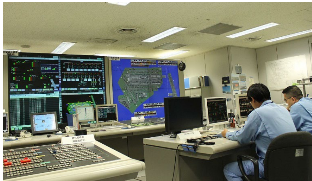
灯火電力監視制御装置
