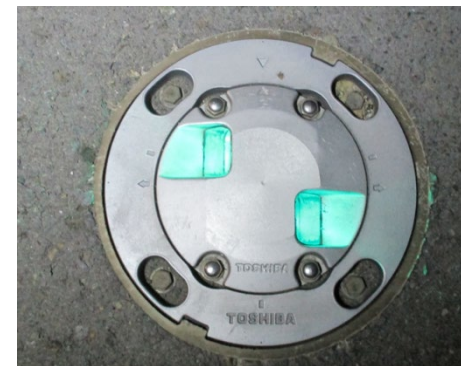
誘導路中心線灯(埋込型)
