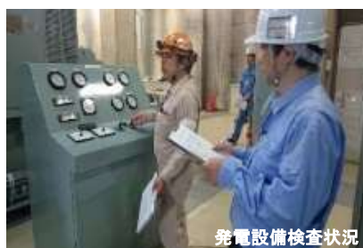
発電設備検査状況
