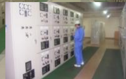
電気施設の日常点検
